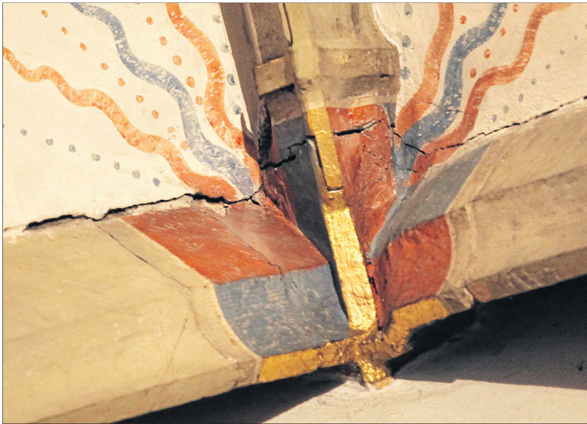
Vor allem an den Schwachstellen des Gebäudes sind die Schäden zu beobachten.
